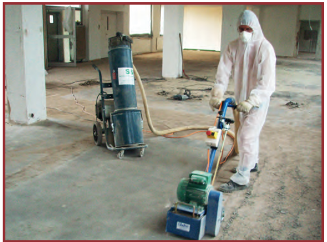
Asbesthaltiger Kleber in Fußböden gehört fachgerecht entsorgt
