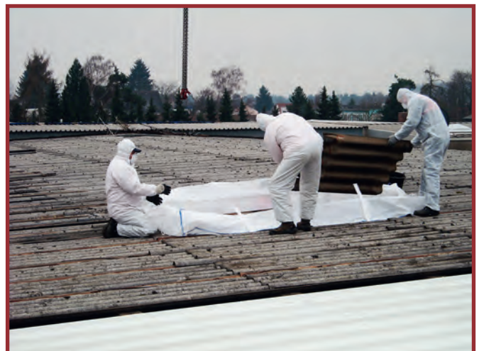
Auch heute noch zahlreich vorzufinden: Asbesthaltige Eternitplatten zur Dachabdeckung
